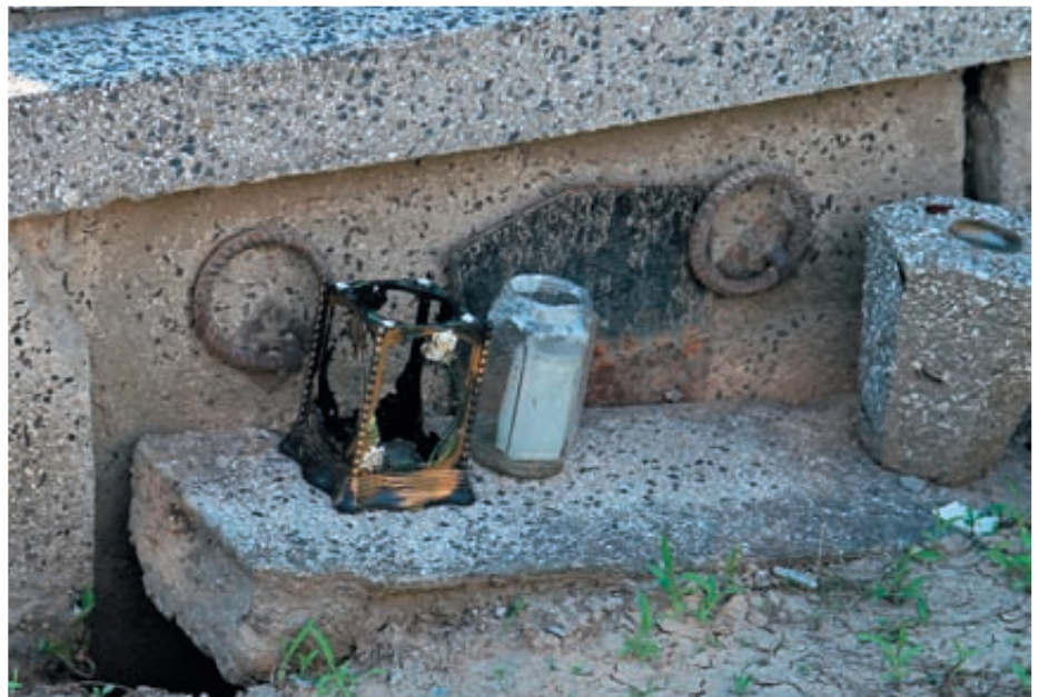
Nieszczelnie wykonany właz umożliwiający np. wplynięcie wody do wnętrza grobowca
